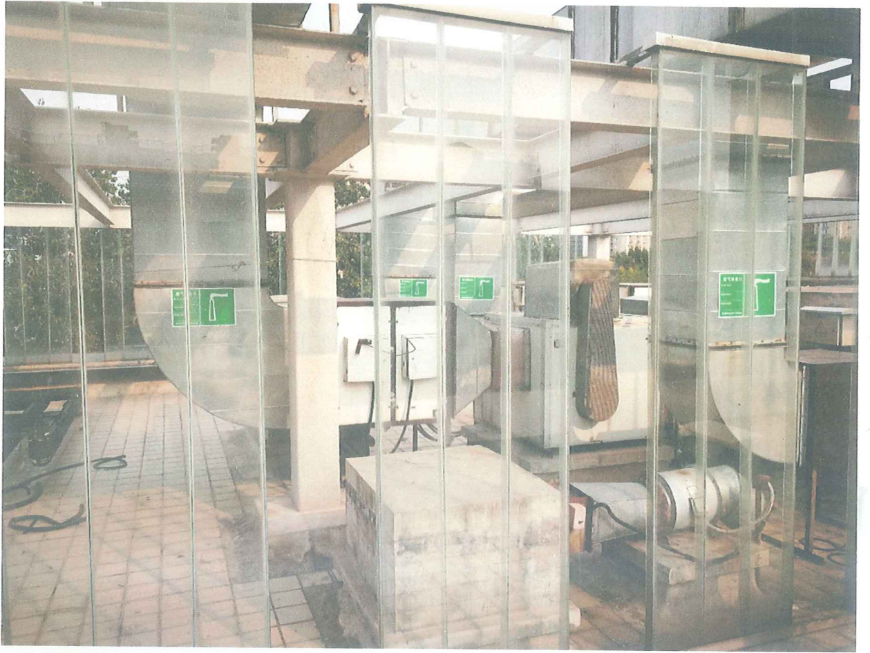
图 4-1 废气治理设施
